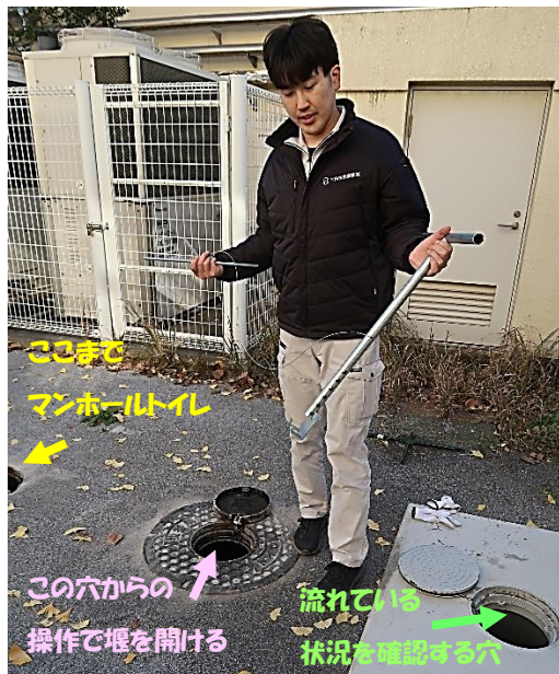
⑮棒と固定バーを使用し、堰の操作をします。
